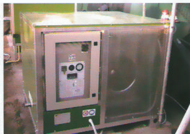
Gruppo di emergenza automatico per pressostruttura.
